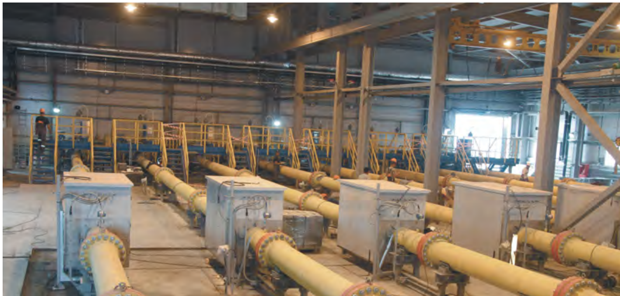
Газоизмерительная станция полностью готова к работе
